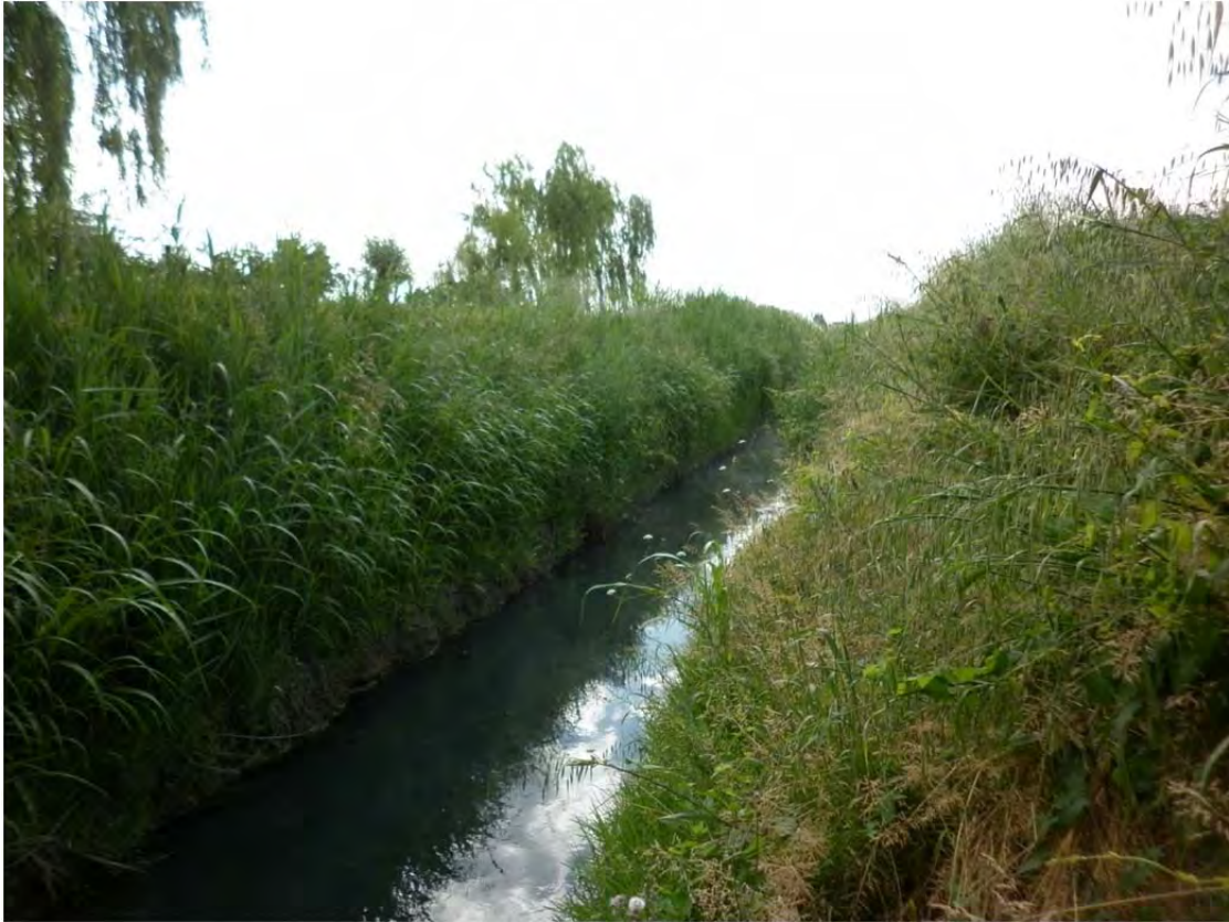
Foto 5: Scolo Paiuzza visto dall'attraversamento ferroviario verso est dove è previsto l'allargamento in sponda destra.
